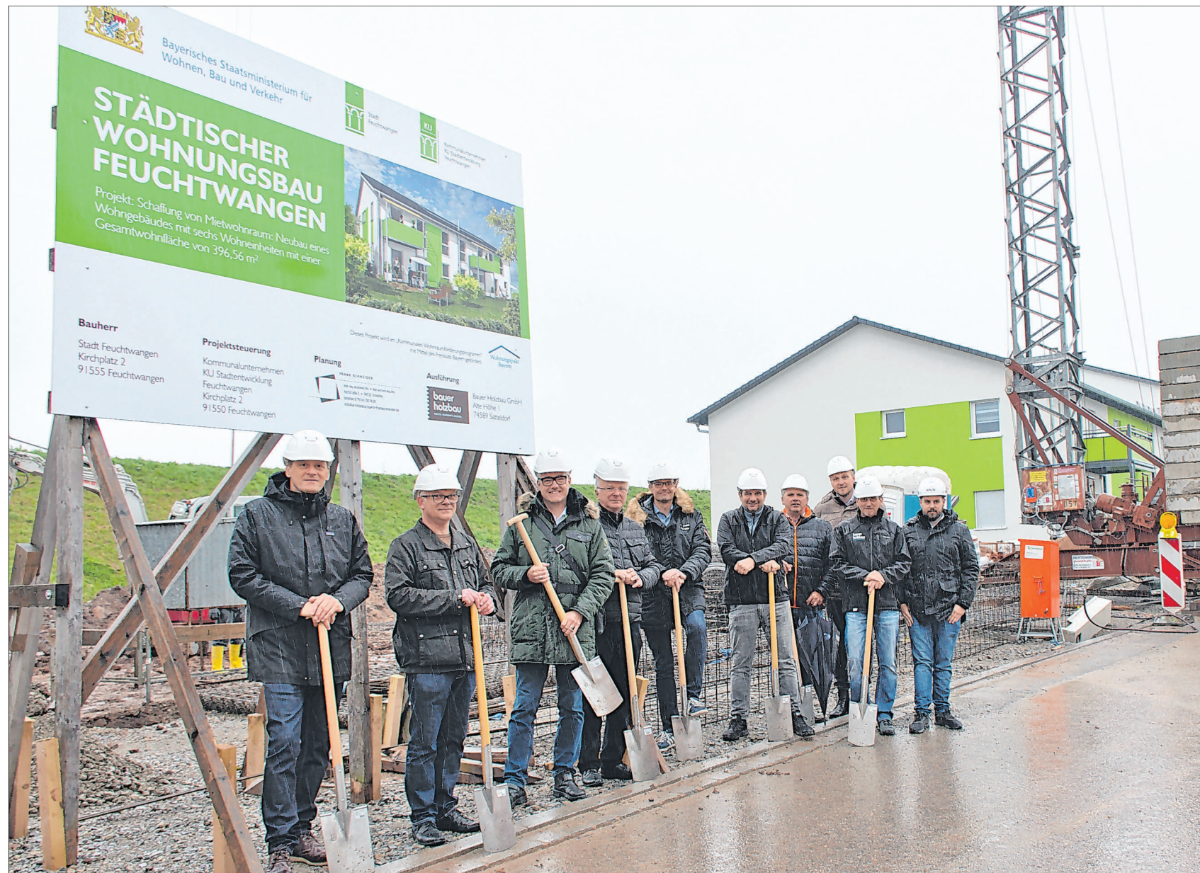
Spatenstich neben dem bereits fertigen Mehrfamilienhaus der Stadt (von links): Architekt Frank Schneider, Dekan Wigbert Lehner, Bürgermeister Patrick Ruh, Pfarrer Christoph Matejczuk, die Stadträte Maximilian von Jacobs und Thomas Heidecker, zweiter Bürgermeister Walter Soldner, KU-Vorstand Arthur Reim sowie Jörg Hiller und Tim Gebauer von der bauausführenden Firma. Foto: Stadt Feuchtwangen/Rebecca Weber
